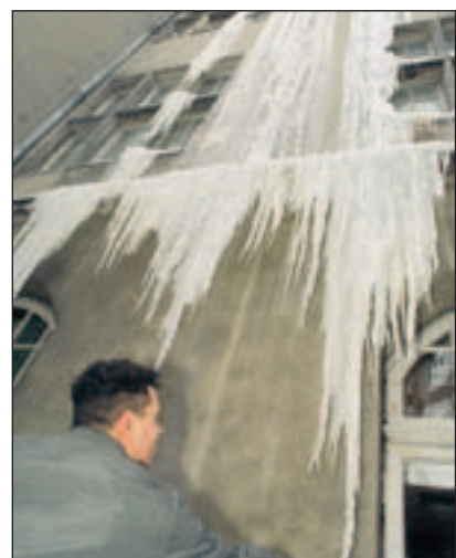
Eis setzte im Winter der Fassade der Uni Hannover zu. Archivfoto: dpa
